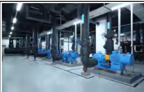
泵房设备排列整齐
