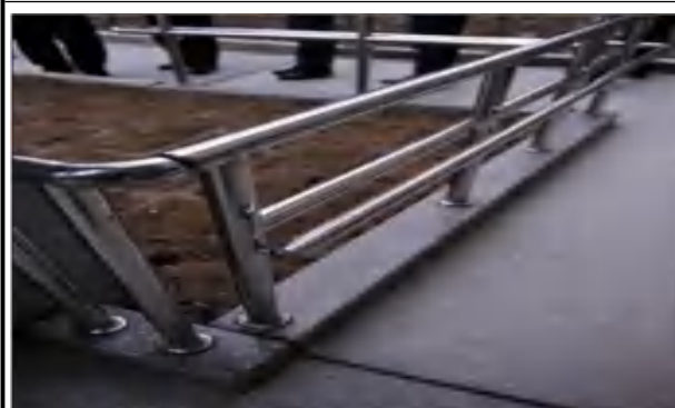
防护栏杆在变形缝处断开
