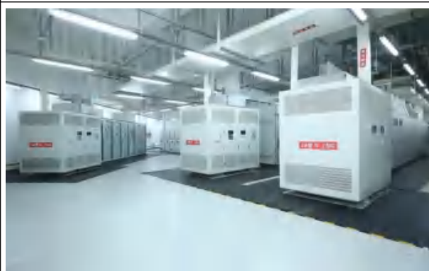
变压器设备排列整齐，系统运行正常可靠
