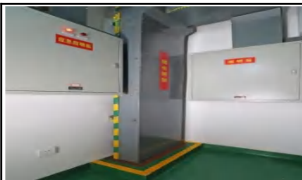
井内设备、桥架排布合理，标识整齐，封堵美观
