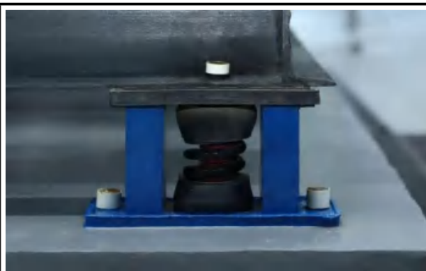
设备基础采用弹簧减震器
