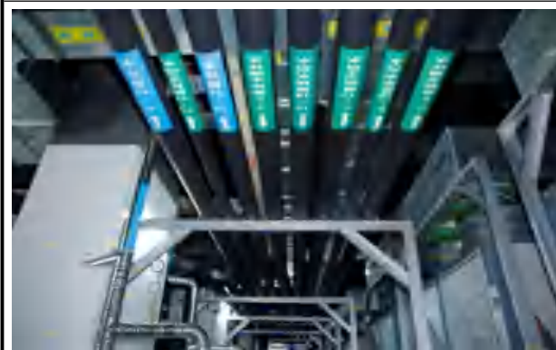
采暖管道采用落地式机架，保温紧密，标识整齐
