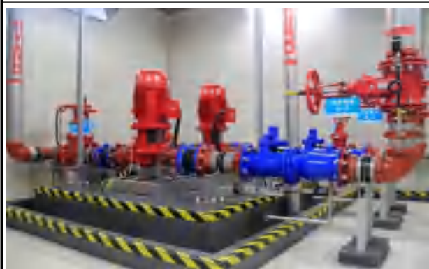
消防泵房布局合理，标识清晰
