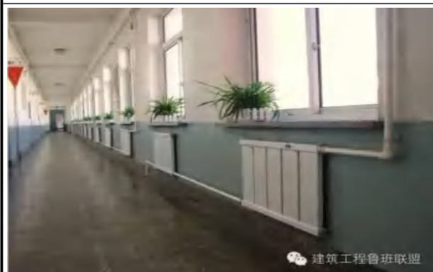
走廊明管横平竖直，管件连接处处理细致
