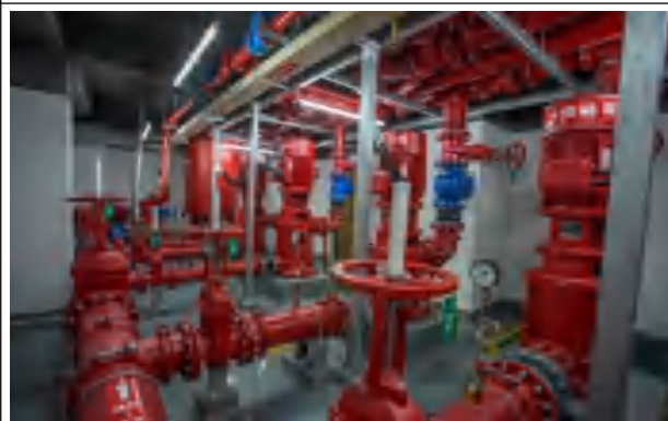
稳压泵房设备整齐，油漆精美，阀门、螺栓用 PVC 套管防腐
