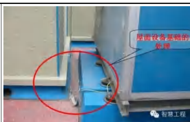
设备基础防震措施
