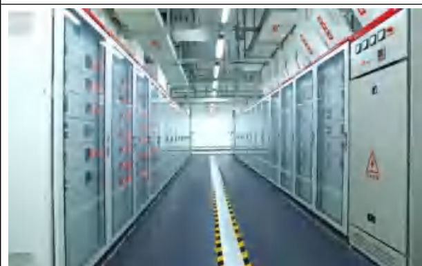
高低压配电柜安装稳固，排列整齐
