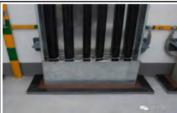
竖向电缆封堵
